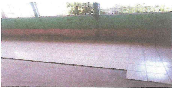
Foto 3: Piso de torta de cemento de la escuela
